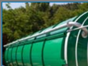
Tubería de carga externa
